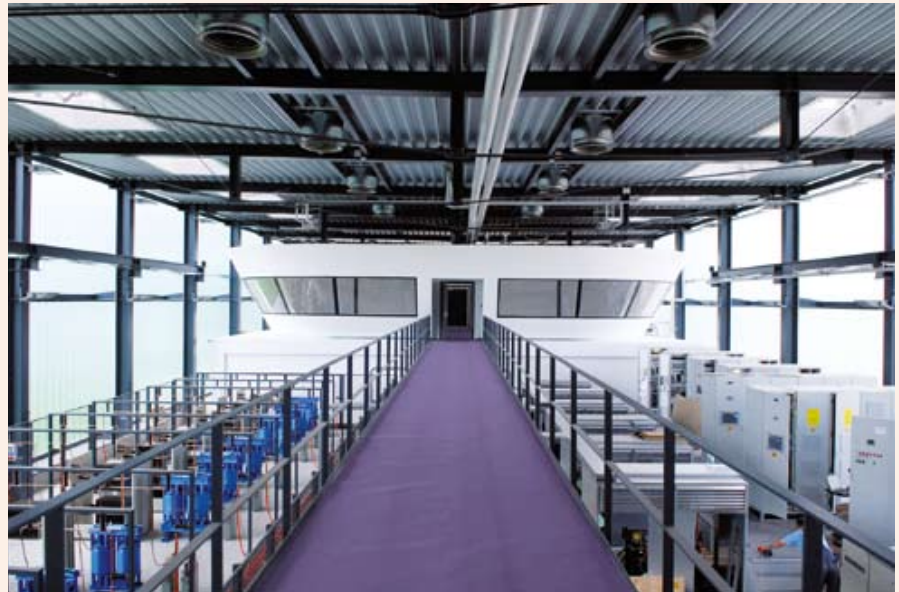
Graciosa im Kleinen. In dieser Halle proben die Experten von Younicos den Ernstfall und simulieren die Stromversorgung mit den Batterien.
