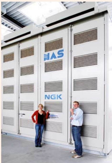
Ein Natrium-Schwefel-Batteriemodul kann sechs Stunden lang 0,5 Megawatt elektrische Leistung liefern, bevor es leer ist.
